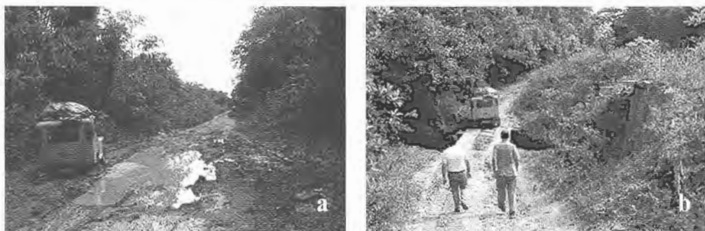
Figura 5. Estado atual do trecho central da rodovia BR-319. (a) Destruição total da pavimentação asfáltica, e em (b) um dos numerosos igarapés com pontes em condições precárias
