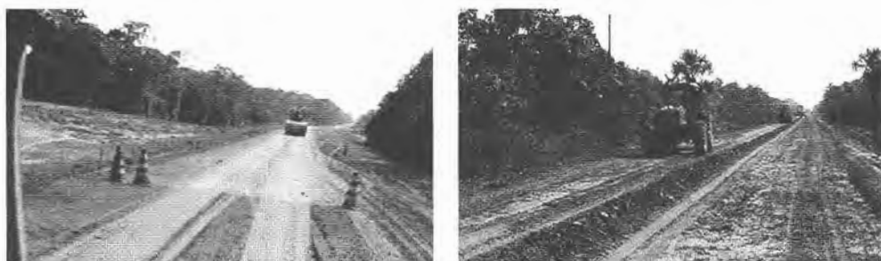
Figura 10. Maquinaria viária trabalhando no primeiro setor da rodovia BR-319. Em (a) setor entre Careiro Castanho e Igapó Açu, quase completamente asfaltado, em (b) setor Igapó Açu – Rio Tupana em recuperação
